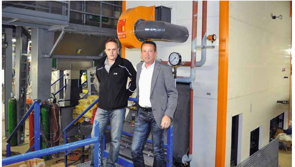
Vizebürgermeister Ing. Leopold Groß besichtigt mit Martin Dittinger von der EVN die technischen Anlagen des neuen Biomasseheizwerkes.
