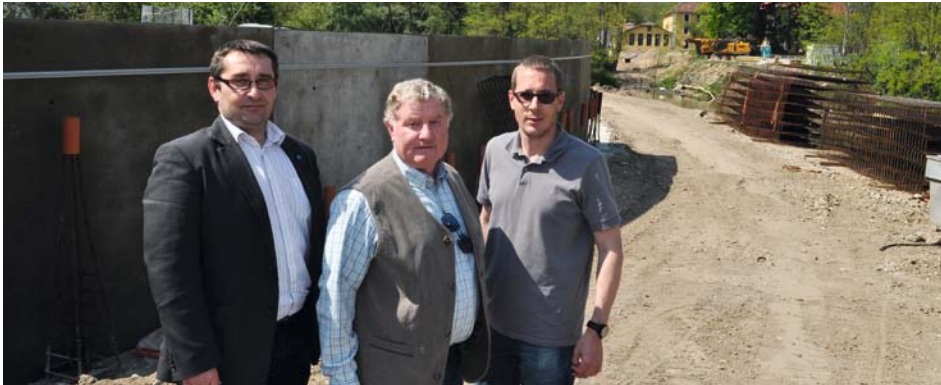
Gemeinderat Michael Jager, Ortsvorsteher Rudolf Hoffmann und der zuständige Referent Stadtrat Stefan Nastl auf der Baustelle neben dem Kamp.
